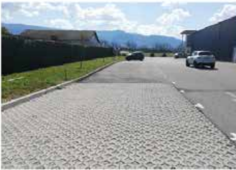
Structure alvéolaire en béton, remplie de graviers, ZI Gloriette à Châtte (illustration)
